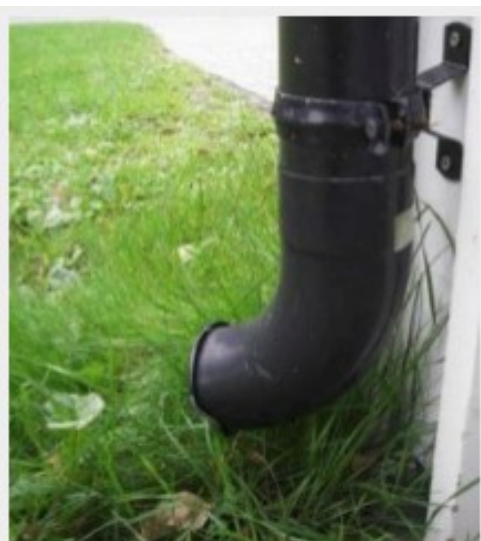
La takrennen lede ut på terrenget slik at vannet ikke renner nedover husveggen og mot husdreneringen.
